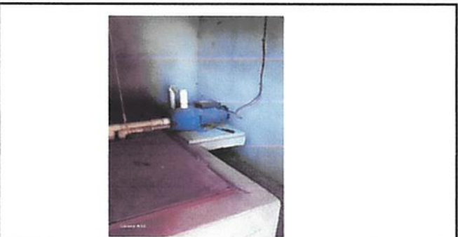
Foto 6: Sustrucción de bomba de agua y chapa en la puerta de la caseta del pozo.
