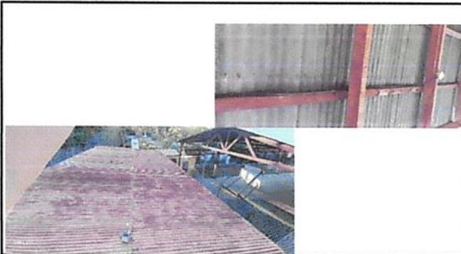
Foto 1: Sustrucción de lámina y estructura del techo, canal de bajada de agua y reparación del sistema eléctrico en el modulo 1 y 2
